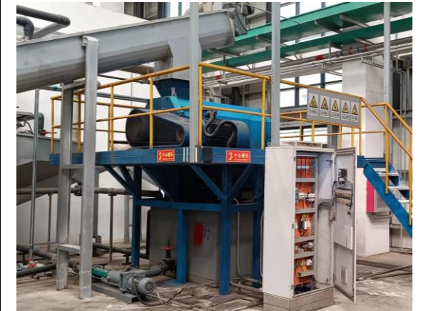
餐厨垃圾挤压脱水工序
