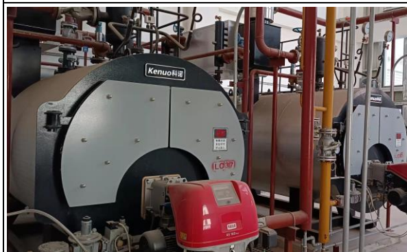
锅炉房（未投运）
