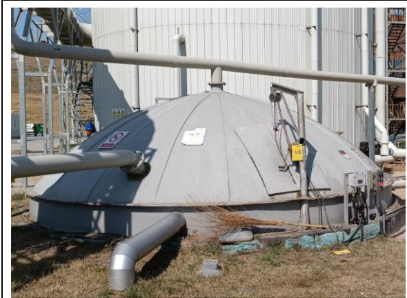
厌氧工序均质池
