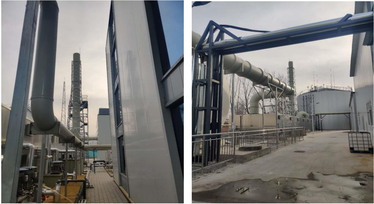
图 11-4 本项目生物除臭设施实景照片
